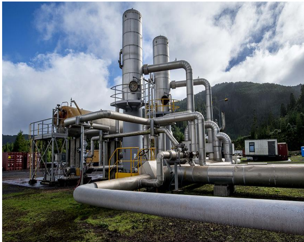
Central Geotérmica na Ribeira Grande- Açores
